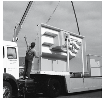
LKW mit Elementbecken (2.3)
